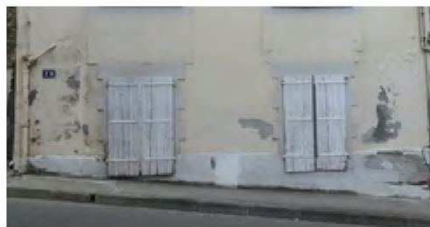
Traces d'humidité sur un mur ancien enduit au ciment. L'eau stockée dans le mur ne parvient pas à s'évacuer.
