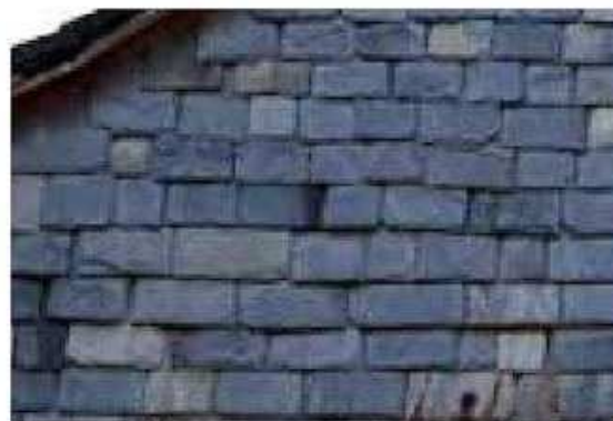
Ardoises posées au clou pour le bardage d'un pignon de grange. Sainte-Colome.
