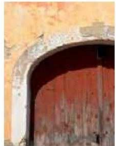
Encadrement reformé à l'enduit et redessiné au badigeon. Verdets.
